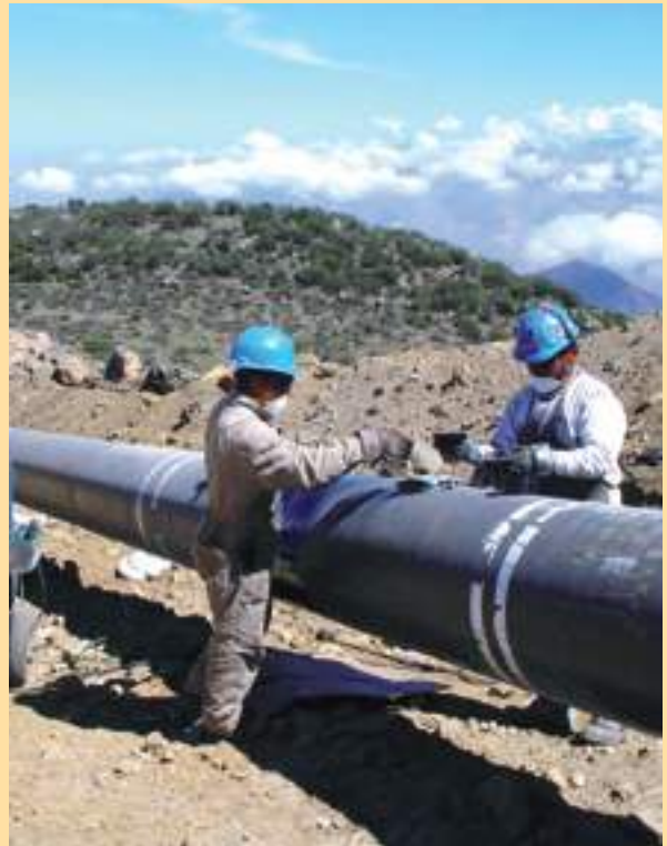
© Transportadora de Gas del Perú S.A.
